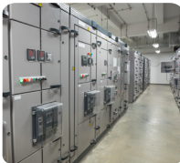
Panel Kontrol Listrik
